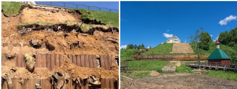
Рисунок 1. Вид на дом и откос со стороны Афанасова поля (а) после аварии и восстановленный (б).
